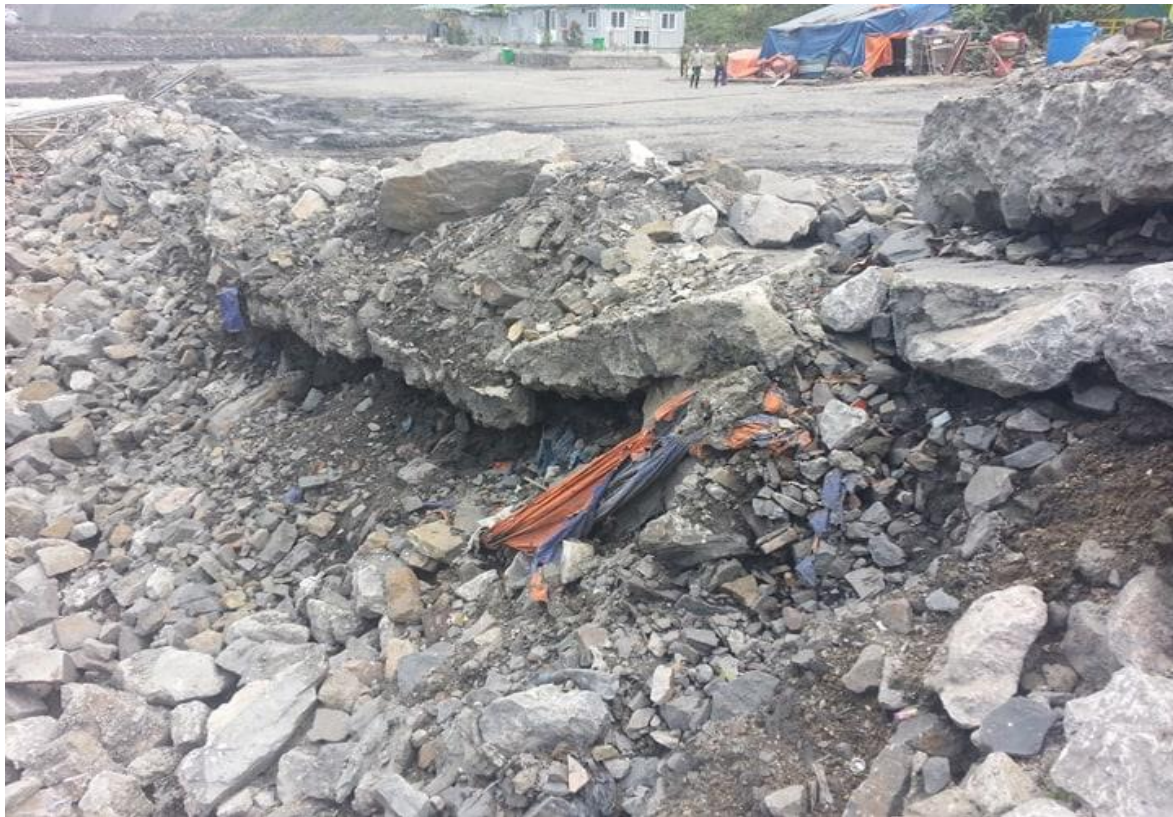
Hình 5. Sạt lở, sụt lún, gãy nền bê tông tuyến đường nội bộ mức +155 (chụp tháng 11/2018).
